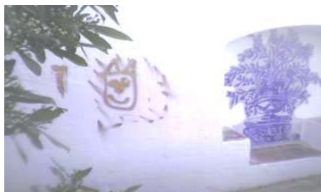
A parede exterior com acesso à piscina toda esborratada.
